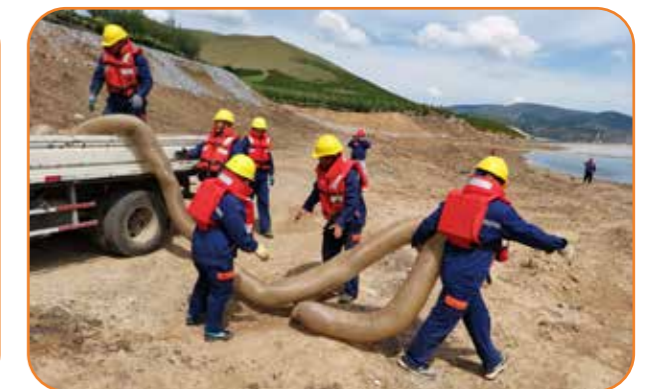
▲ Exercice mené par la SARL de l'Industrie minière Baiyinnuoer de Chifeng dans un bassin de résidus pour faire face à l'inondation survenue
