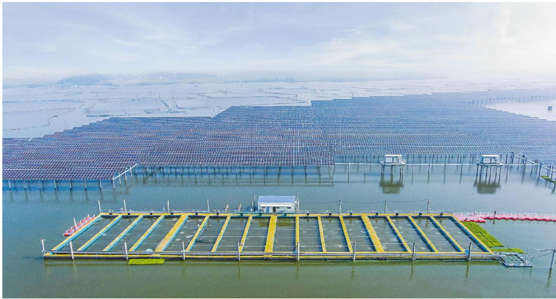
通威泗洪“渔光一体”基地
