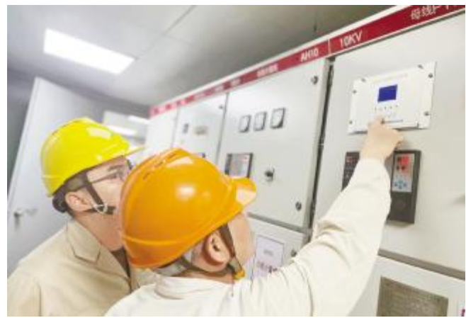
巡检设备,保障电站安全运行
