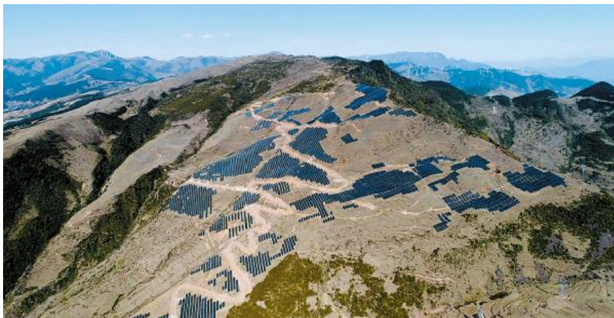
通威喜德农光牧光一体光伏扶贫电站
