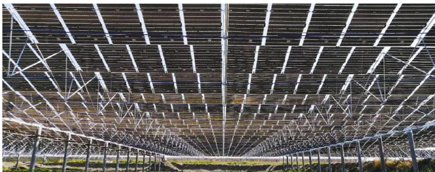
天津杨家泊二期项目柔性系统
