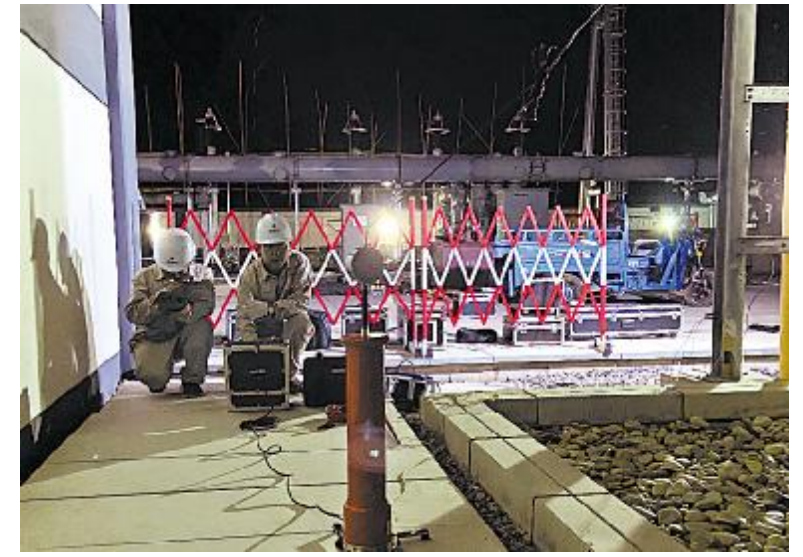
升压站夜间预试
