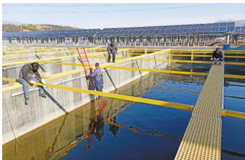
低水位固定式循环槽更换微孔增氧阀门
